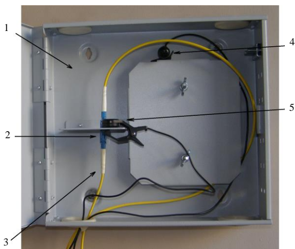
Рис. 5. Оптический кросс (1) с оптическими кабелями (3), соединенными адаптером (2), и системой акустического контроля в составе микрофона (4) и пьезодатчика (5)
